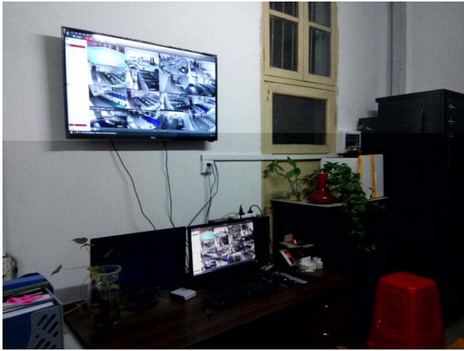
实验监控系统建设监控室
